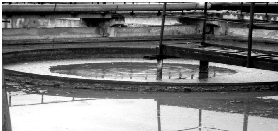
Рисунок 4 – Аэротенк Вергунских очистных сооружений с активным илом (фото Цыбы Н.)
