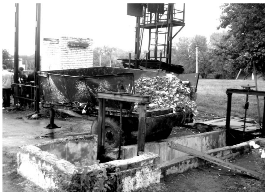
Рисунок 1 – Начальный этап механической очистки сточных вод на Вергунских очистных сооружениях (г. Луганск) – решетка (фото Цыбы Н.)
