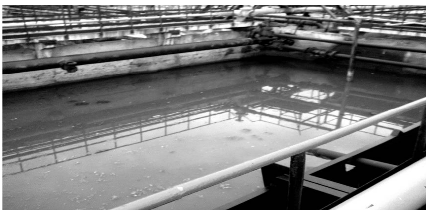
Рисунок 3 – Аэротенк Вергунских очистных сооружений в период отключения электроэнергии (фото Цыбы Н.)
