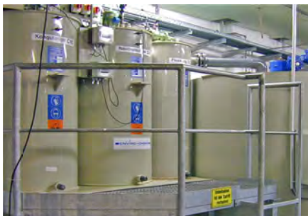
Рисунок 3.31–Установка для хлорирования воды
